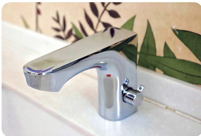
图 D.10-1 北京大兴国际机场 洗手池配置感应式水龙头
