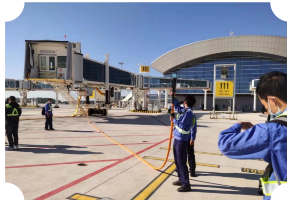
湛江机场 APU 替代设施
