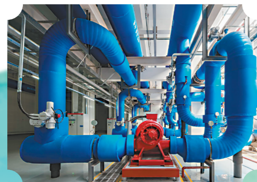
北京大兴机场地源热泵系统
