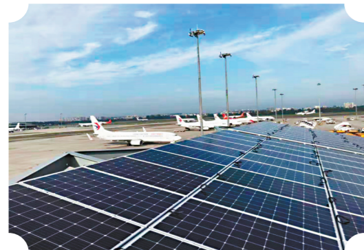
四川双流机场南机坪7000余平光伏车棚
